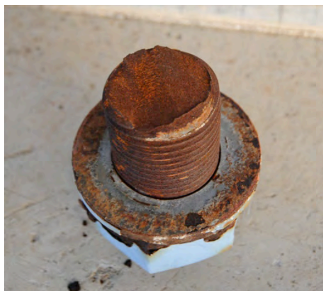
破断したボルト断面
