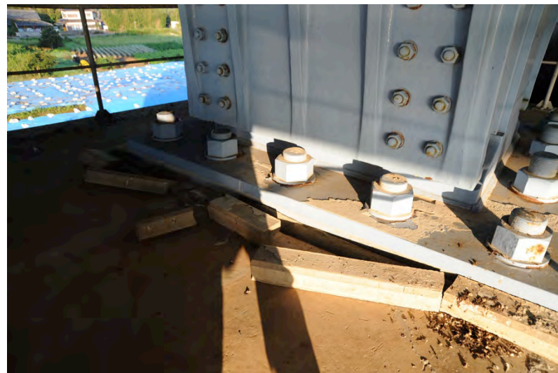
支承取付部の損傷
