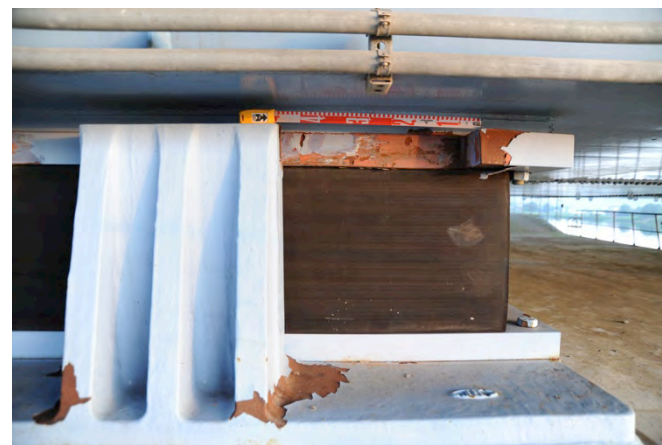
橋軸直角方向側面(川下側) 両方向の変位制限装置に衝突
