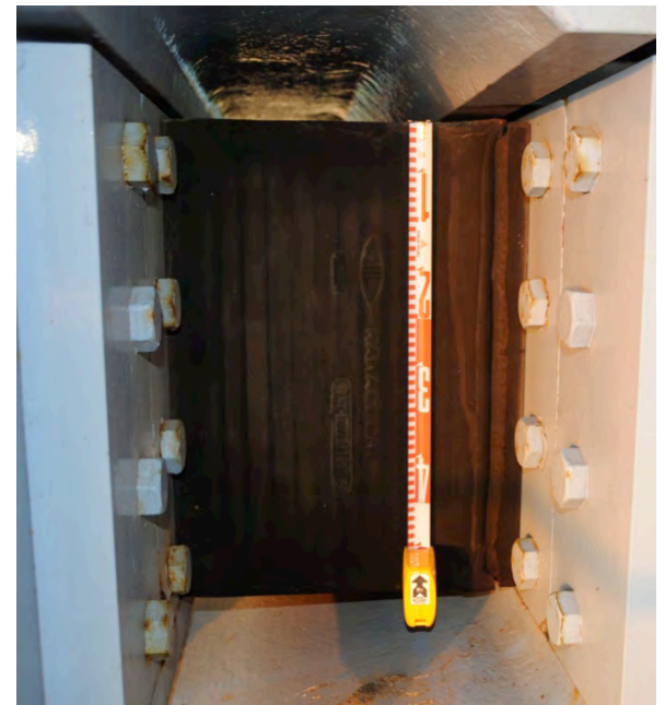
川下側ゴム支承の破断 (ひたちなか側)
