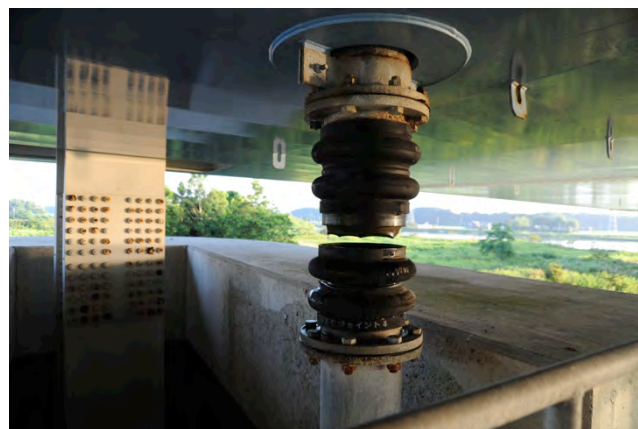
パイプジョイントの破断
