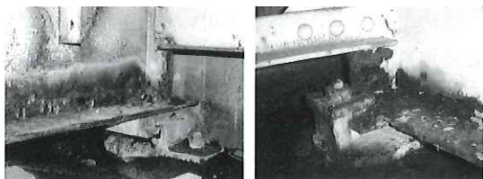
写真-2 鋼桁の端部に生じた腐食の例
