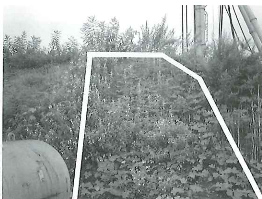
写真-3 施工後10ヶ月経過 枠内が写真2での吹付けの範囲
