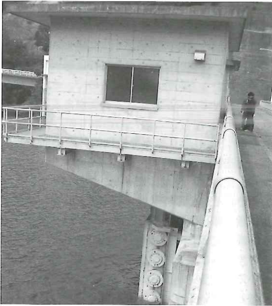
図-3 賀祥ダムの補助ゲート操作室
