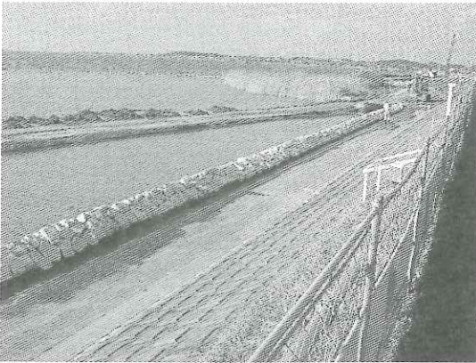
写真-2 霞ヶ浦 (永山地区) における復元事例 (施工中の写真)。もともと直線的なコンクリート護岸であった。水際も直立護岸で連続性がなかった。
