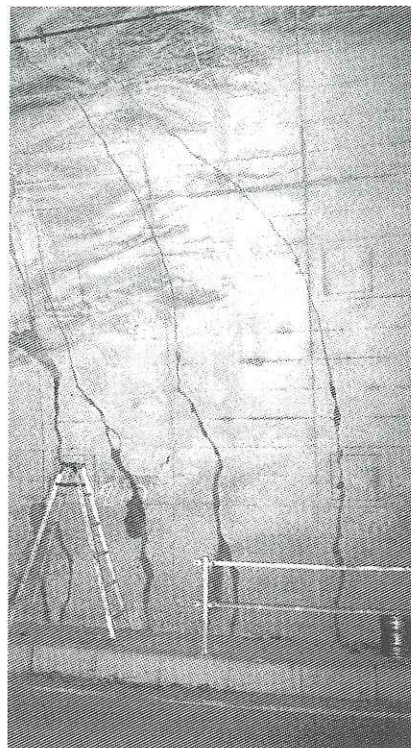
写真-4 木沢トンネルの被害状況 (横断方向のひび割れ)
