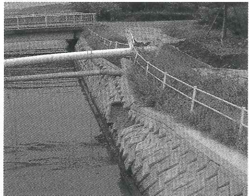
写真-1 橋台とその近傍護岸の変状例
