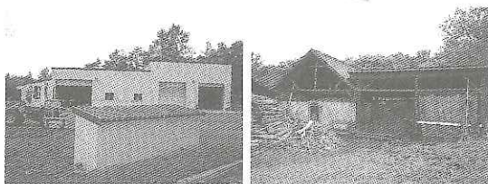
流木粉碎設備(札内川ダム) 炭焼き窯 写真-3 札内川ダムにおける流木処理施設
