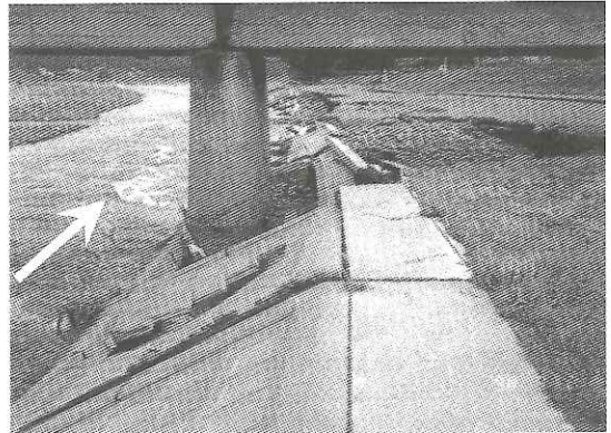
写真-1 阿武隈川(平成10年) 橋梁の上下流で、河岸侵食の程度と範囲が異なっている状況が見られる。
