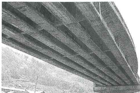
写真-1 塩害による損傷を受けた橋梁
