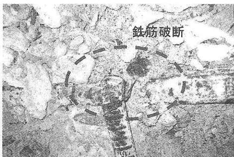
写真-2 ASRによって破断した鉄筋
