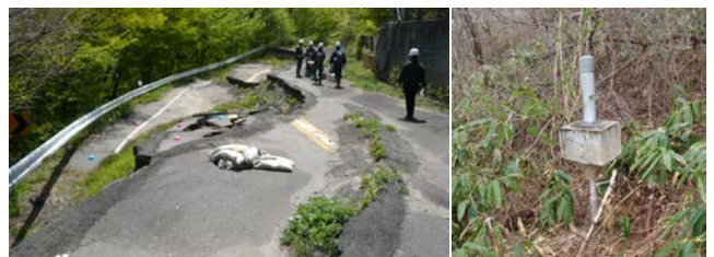
写真-1 地すべり頭部の道路面の陥没状況
