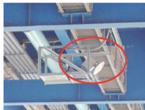
図-5 橋桁下に設置された電波流速計
