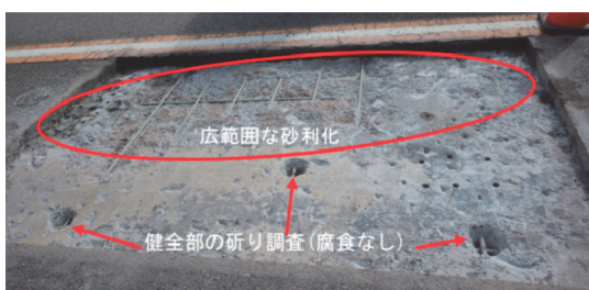
写真-8 床版上面の土砂化（大岩橋）
