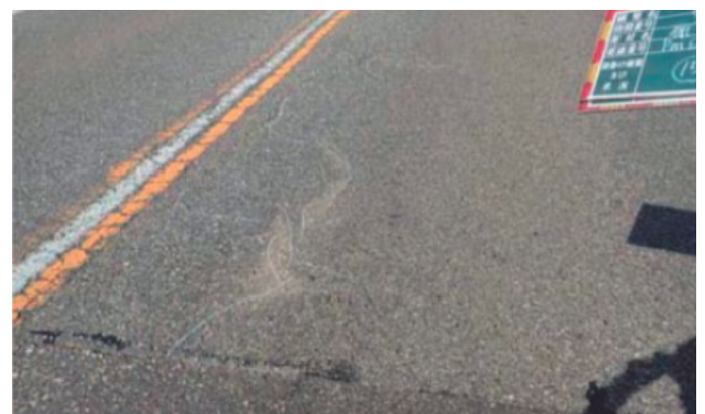
写真-10 舗装面の土砂析出（大岩橋）
