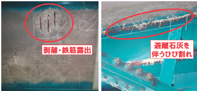
写真-3 損傷状況（犀川大橋）
