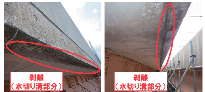
写真-1 損傷状況（高堂高架橋）
