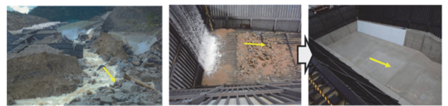
図-9 熊野地区における排水路破損状況
