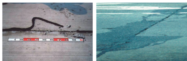
図-2 左：路面損傷の例、右：構造損傷の例
