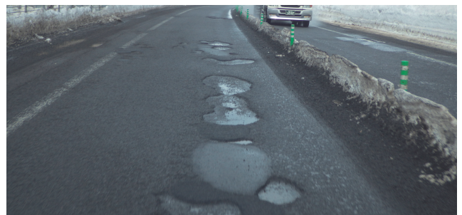
写真-1 高規格幹線道路の排水性舗装に発生した破損
