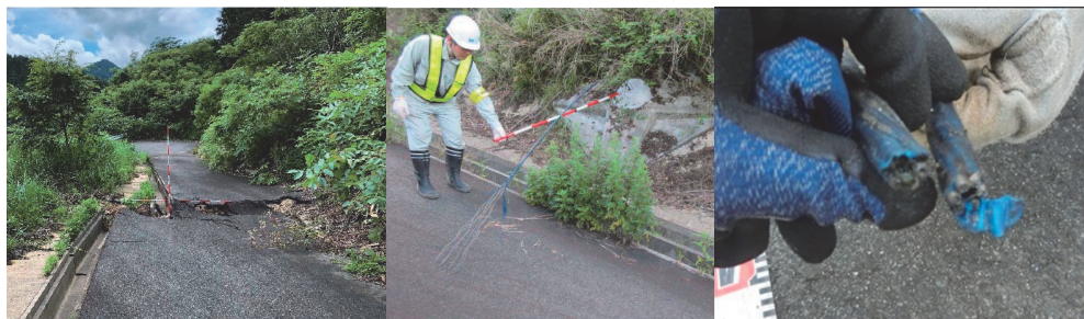
写真-1 管理道路横ズレ 写真-2 アンカー飛び出し 写真-3 アンカー破断面
