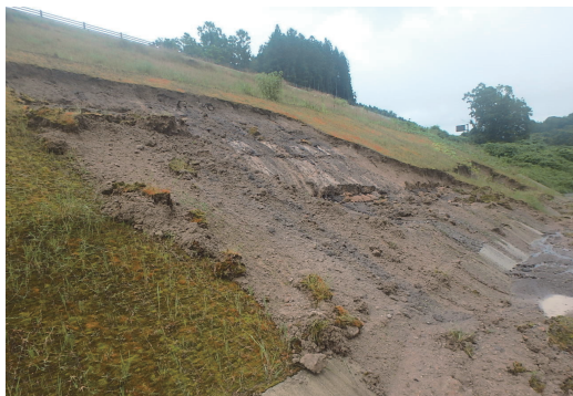
写真-1 施工初期の植生のり面の表層崩壊例
