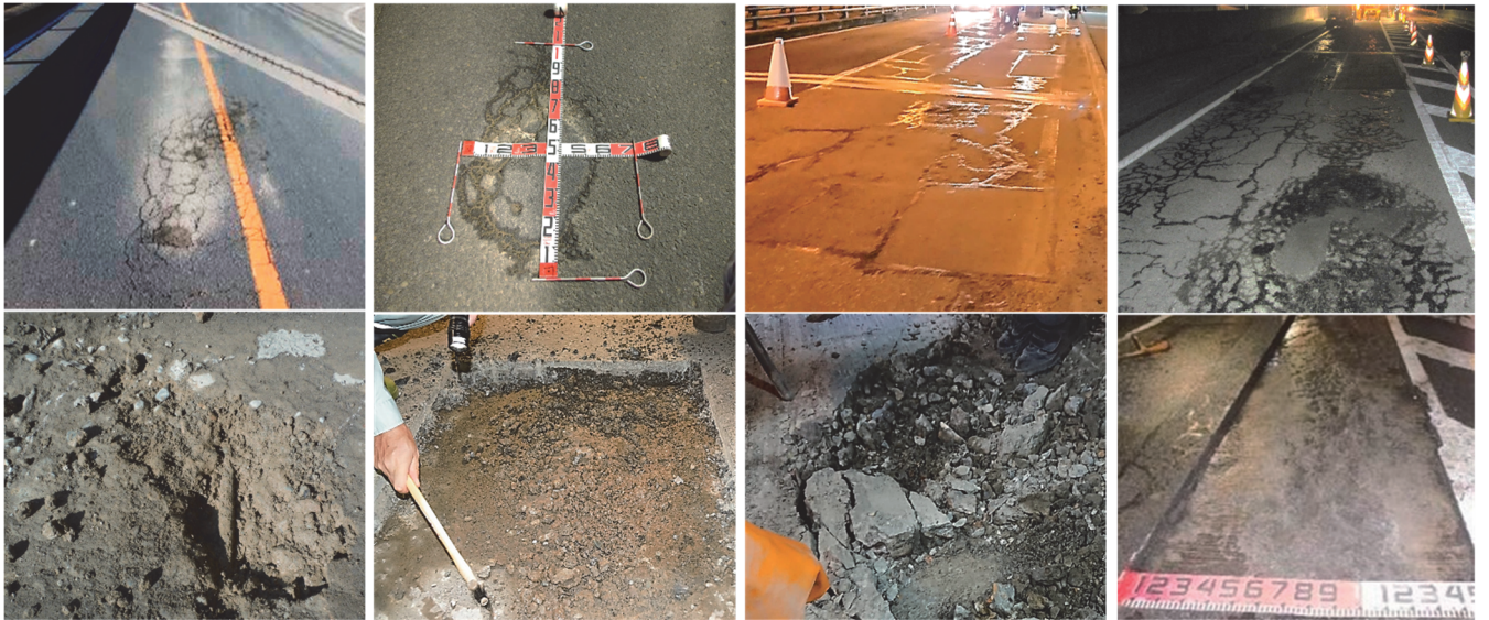
(a) 粘性のある泥状化 (b) 細かく破碎された碎石状 (c) 水平ひびわれ上のブロック状剥離 (d) 健全であるが薄い剥離・肌荒れ状
