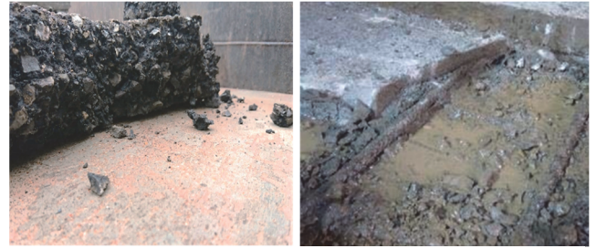
写真-4 舗装の骨材剥離 写真-5 補修箇所再劣化
