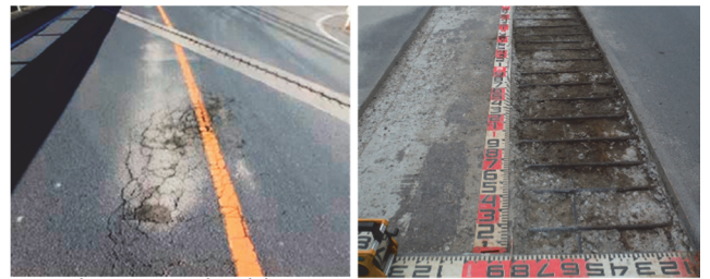
写真-1 路面からの土砂噴き出しと舗装開削前後の状態
