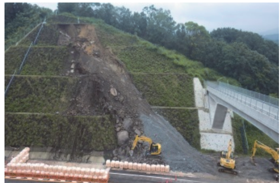
写真-1 荒堀地区の法面崩壊事例
