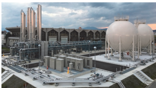
図-1 消化ガス精製装置
