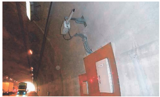
写真-1 煤煙透過率計（受光部）の設置例
