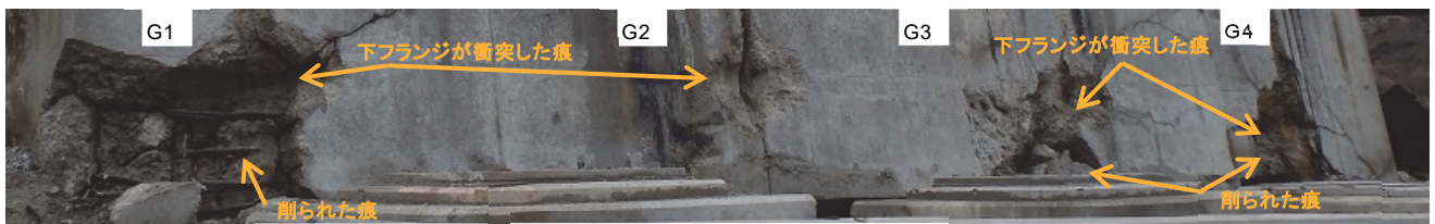
写真-1 A2橋台の損傷状態
