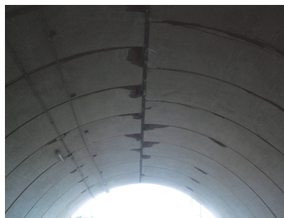
写真-1 プレキャストアーチカルバートの被災状況
