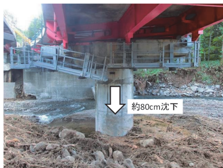
写真-1 洗掘で被災した橋梁
