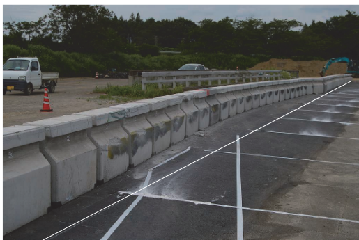
写真-3 衝突後の防護柵の状況
