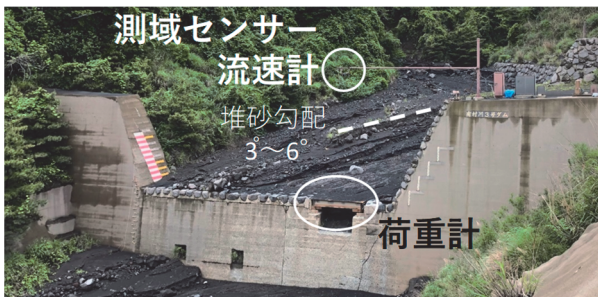
図-2 土石流観測機器の配置
