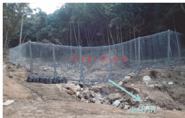
写真-6 備蓄資材(強靱ワイヤーネット)の活用による工期短縮の事例 (広島市安佐北区小田川)
