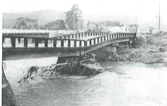
写真-1 洗掘による橋脚の傾斜
