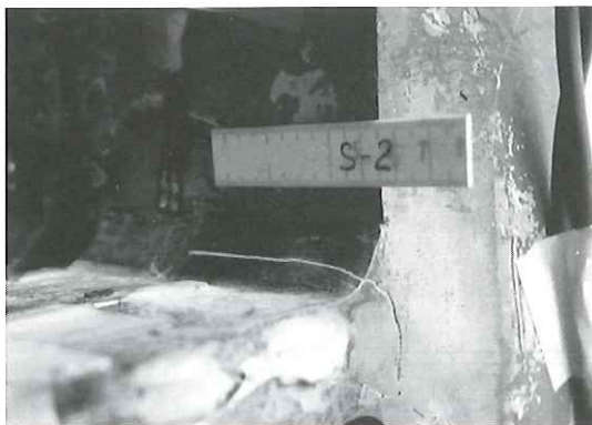
写真-4 鋼製橋脚隅角部の磁粉指示模様
