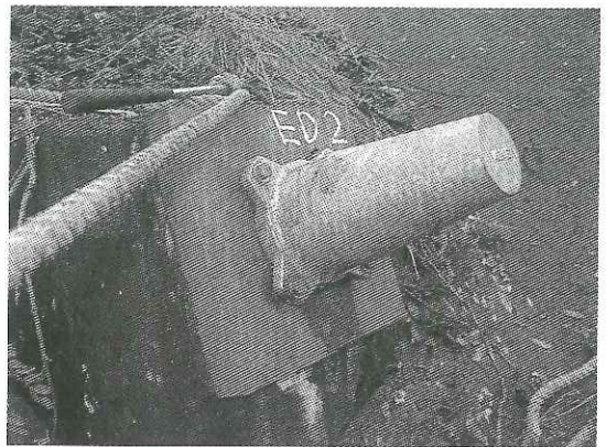
写真-4 防錆油の流出した痕跡
