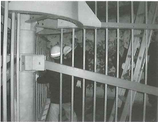
写真-6 設置されたみずみち棒の点検（銭函下水処理場）
