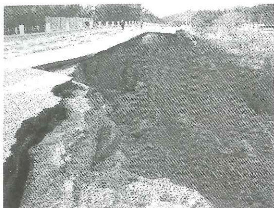
(a) 崩壊状況
