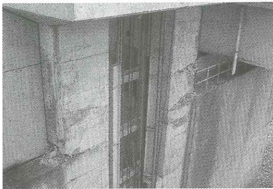
写真-1 妙見堰の門柱被害 (2004年新潟県中越地震)
