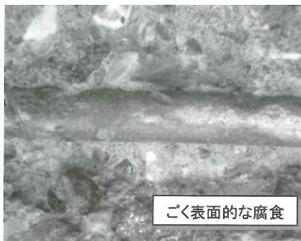
図-11 RC床版橋RC5の鉄筋腐食状態
