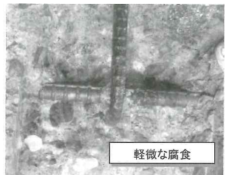
図-12 PC橋PC5の鉄筋腐食状態
