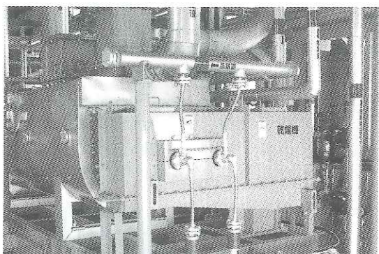
写真-6 乾燥機（間接蒸気加熱式）
