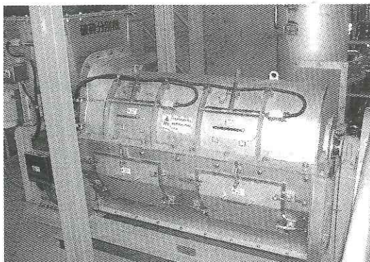
写真-2 生ゴミ破碎分別機
