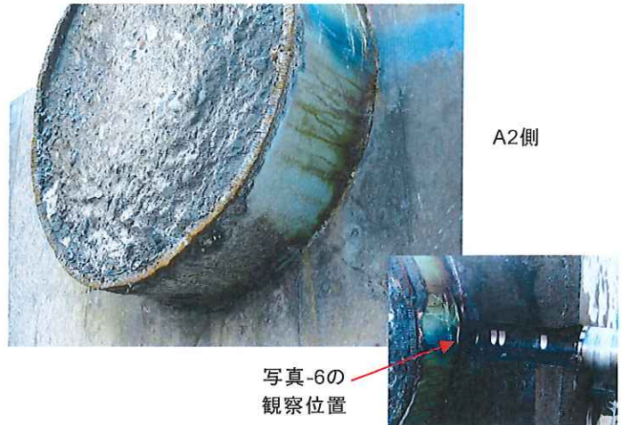
写真-5 パイルベントの腐食状況(解体ヤードで撮影) 注) 鋼管径711mm、板厚15mm、右下はコア採取状況
