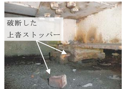
写真-2 支承の損傷
