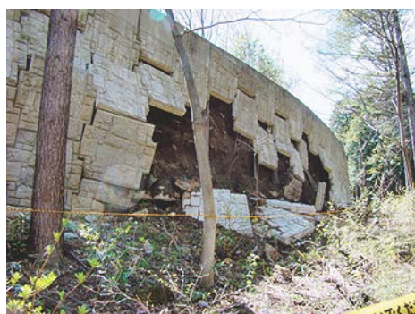
写真-2 補強土壁の壁面の崩落例
