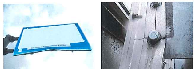
写真-4 車両衝突による標識板取付部の損傷
