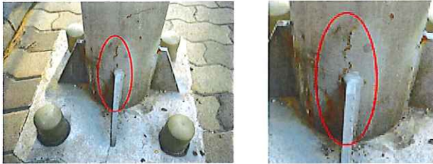
写真-2 溶接部の疲労き裂
