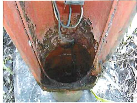
写真-3 支柱内部の滞水及び腐食
