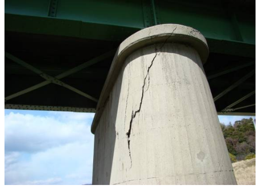
写真-1 壁式RC橋脚における橋座部のせん断損傷 2)
