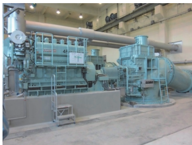
図-1 糠田排水機場ポンプ設備
