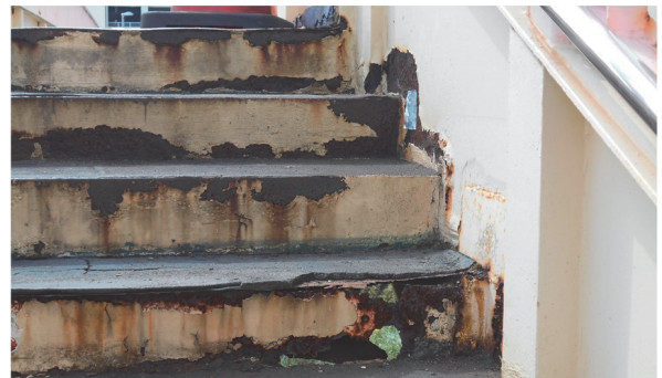
写真-3 幕張二丁目歩道橋の著しい腐食
