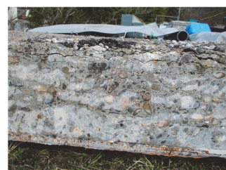
写真-10 床版内部のひび割れ
