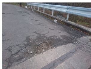
写真-2 橋面の損傷状況
