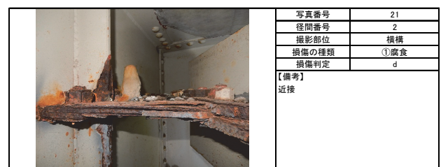
図-3 代表的な損傷状況（局所的な著しい腐食）
