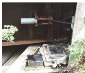
写真-2 支承の破断 （A2橋台）
