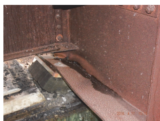
写真-3 主桁支点部の変形 （A1橋台）
