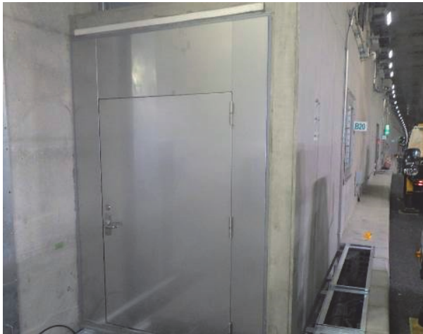
写真-1 独立避難通路と出口扉
