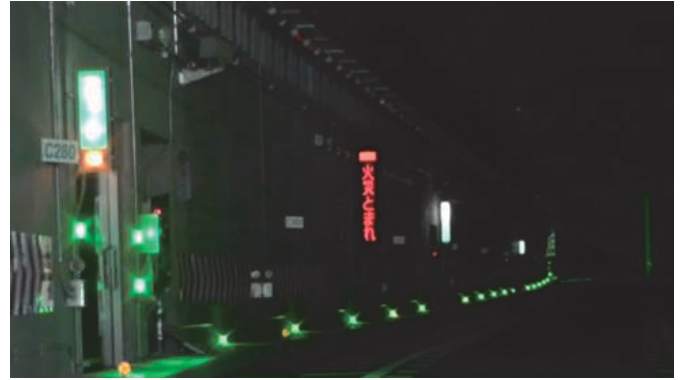
写真-3 足元誘導灯
