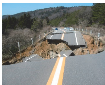
写真-3 盛土崩壊
